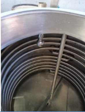
SOĞUTMA TANKI (-15C°) (COOLING TANK -15C°)
