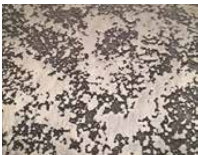
Bronzo corrosivo Corroded bronze
