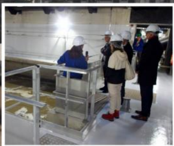
Nouvelle station d'épuration du SIAH à Bonneuil-en-France
