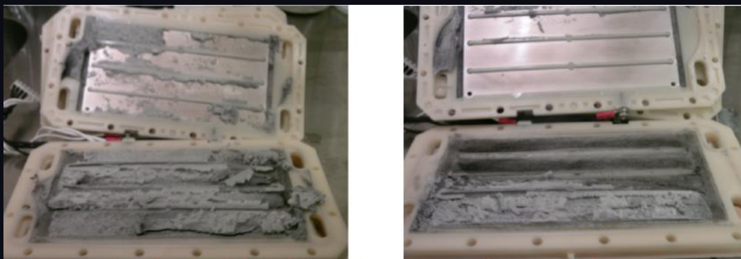
Chambre d'électrolyse jamais nettoyée — calcaire accumulé
