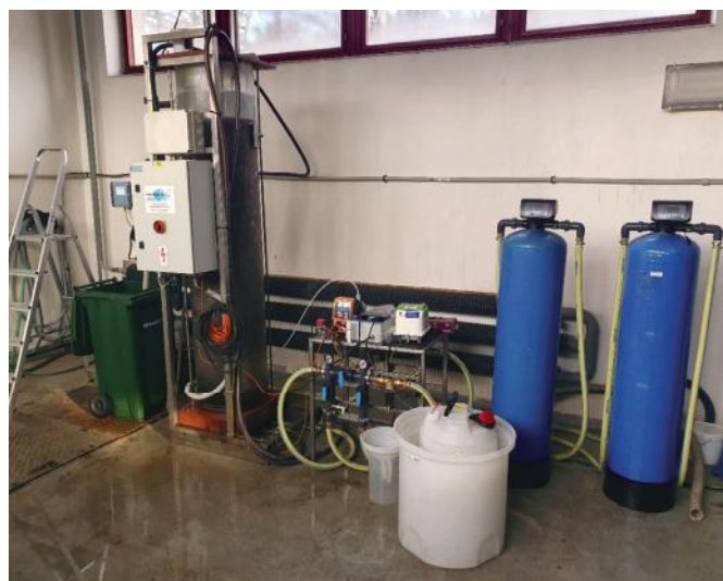
Obr. 1: Pilotní jednotka na ČOV Liberec.
