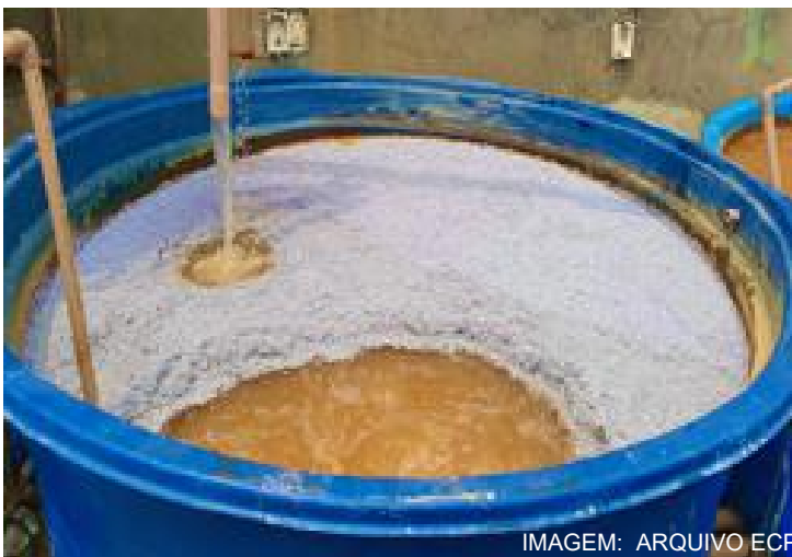
ETDI MÓVEL (ESTAÇÃO DE TRATAMENTO DESCONTAMINANTE IN LOCO)
