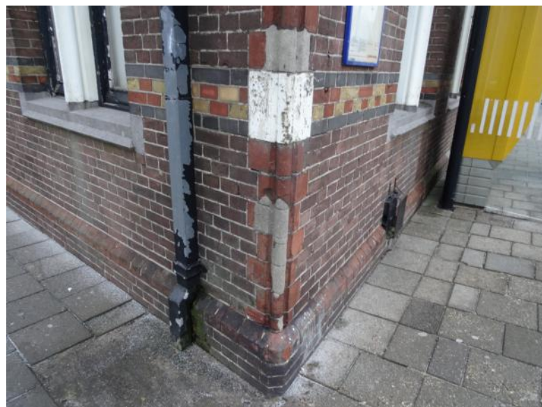
Afb. 5.11 Sterk beschadigde, met betonmortel aangeheelde hoekband op de zuidwesthoek van het gebouw. Op de gemetselde plint is zichtbaar dat de bovenrand van verblendsteen door vervuiling mee-kleurt met de baksteen.
