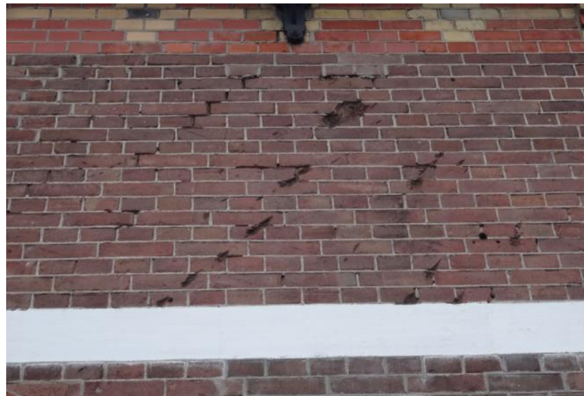
Afb. 2.12 Schade door granaatscherven in de oostgevel van het pleinegebouw.
