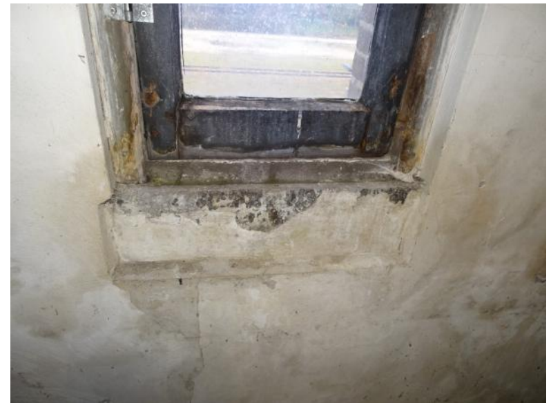
Afb. 5.36 Vochtschade door slecht onderhoud, bij het zolderraam in de zuidgevel.
