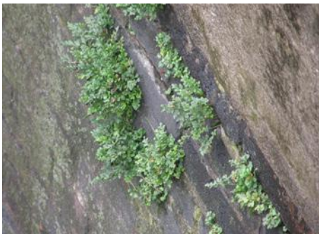
Muurvaren op een oude kerkmuur
