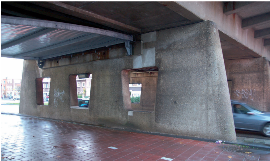
Trapeziumvormige betonschijven van het viaduct. Linksboven is de constructie ter voorkoming van lekkage zichtbaar
