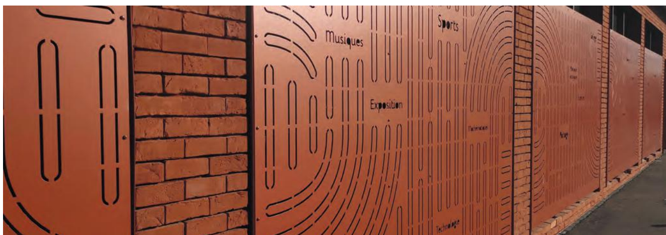
↑ Tôles galvanisées recouvrant les vitres de la salle de sport
