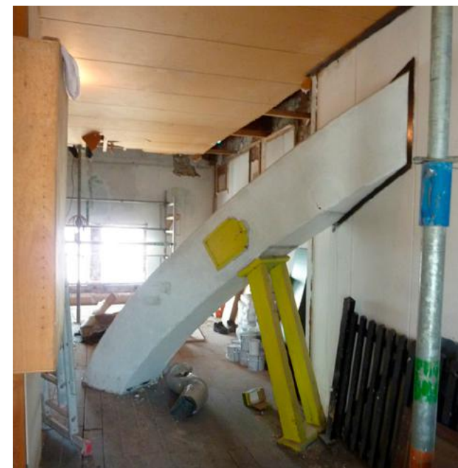
Schoorsteenleiding op de zolder van de woning van de stationschef.
