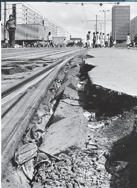
Abgesackte Steine, schwingende Gleise: So sah die Zentralhaltestelle mangels Wartung Anfang der 1980er Jahre aus. Und solche Zustände möchte keiner noch einmal haben.
