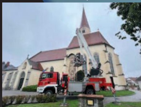
27. August 2023: Sturmschaden am Kirchendach - St. Florian/n
