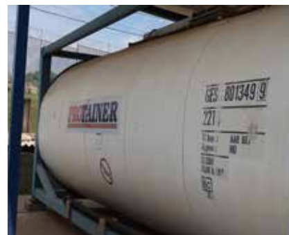
Tanque de armazenagem de Pentano
