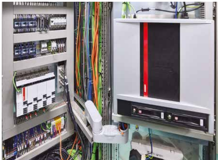
Ein Schaltschrank-Industrie-Server C6670 (r.) koordiniert sämtliche Maschinenabläufe, unter anderem über das Multiachs-Servosystem AX8000 (l.).
