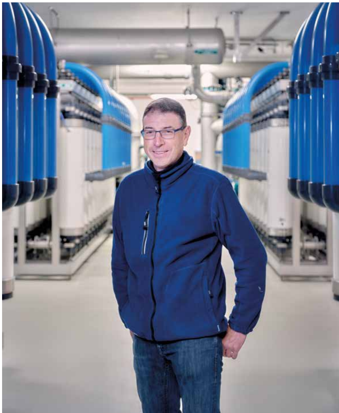
Laurent Menoud dans l'usine de production d'eau potable à Lutry
