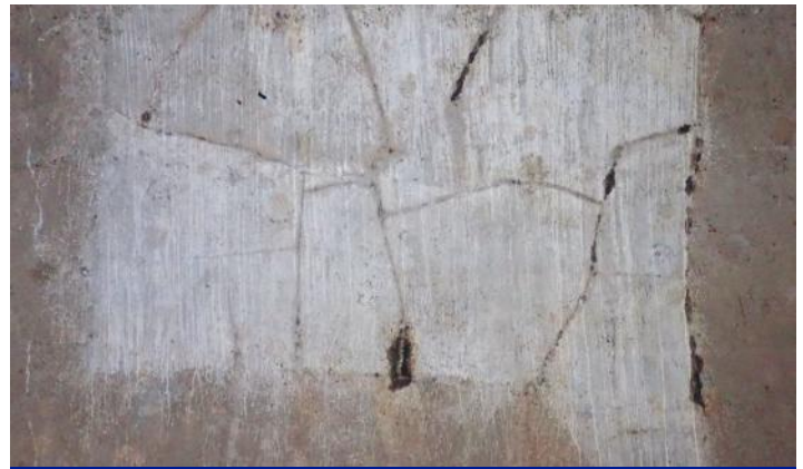
Fig. 2: Muro de concreto previamente reparado (foto cortesía de WJE)
