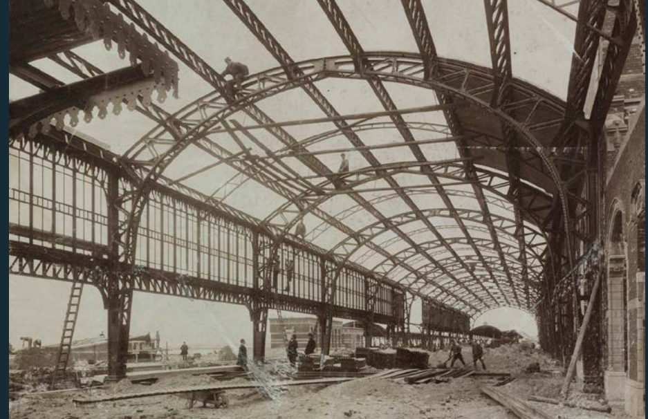
De indrukwekkende stalen spooroverkapping van 's - Hertogenbosch (hier in aanbouw) was met ruim 477 meter de langste van Nederland in die tijd. Foto uit 1898, [GVN].
